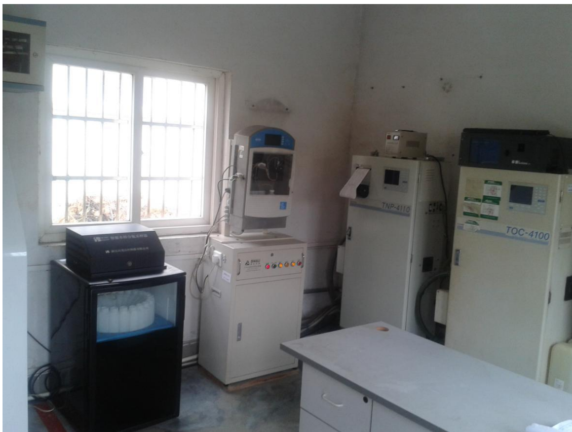
废水在线监测系统
