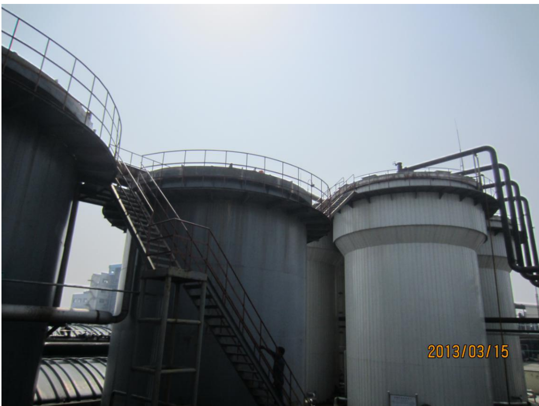
污水处理高效厌氧反应器
