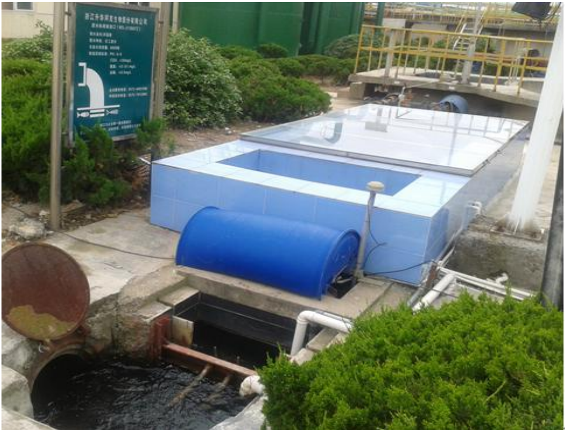
废水阳光排放口
