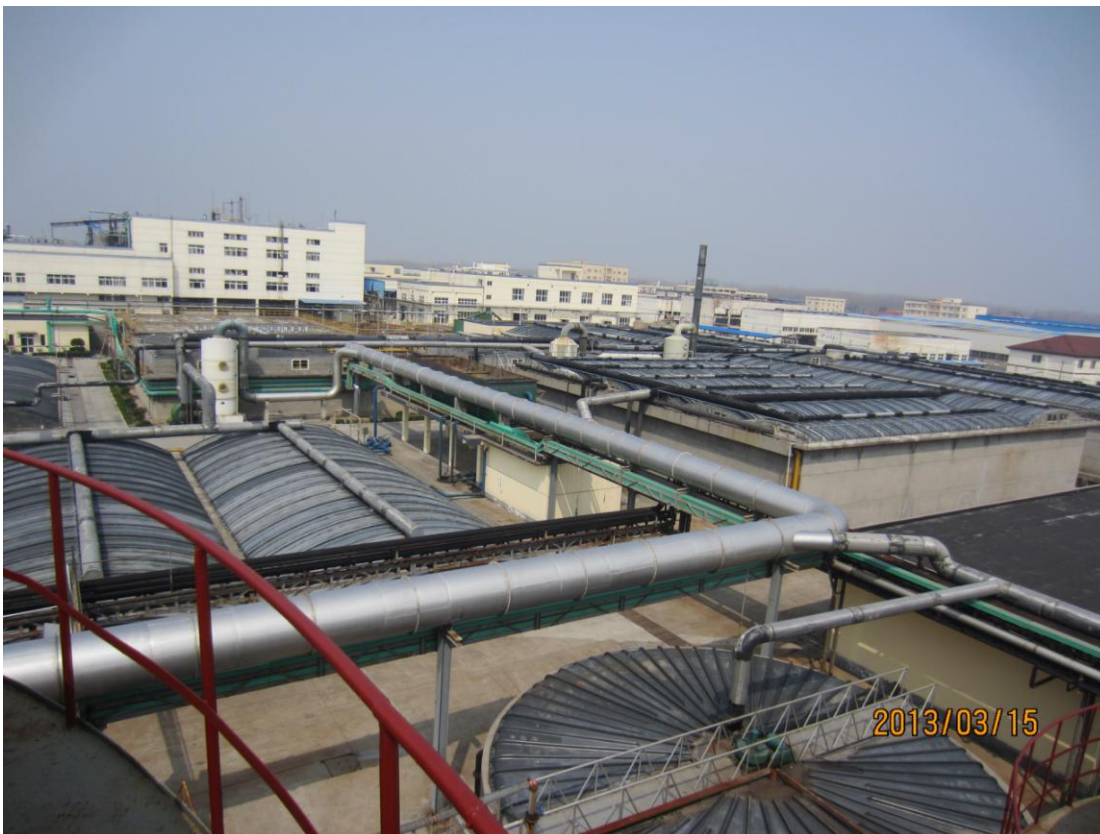
污水处理废气加盖系统
