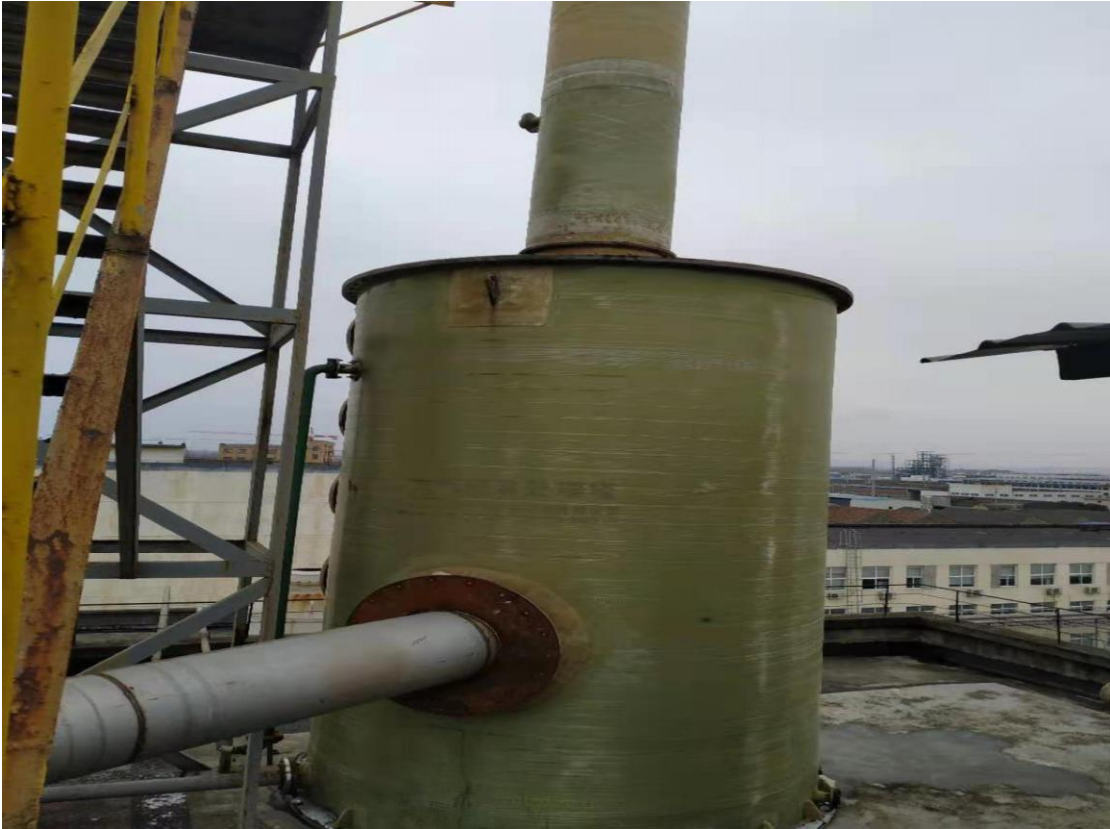
莱福精制一碱喷淋吸收装置
