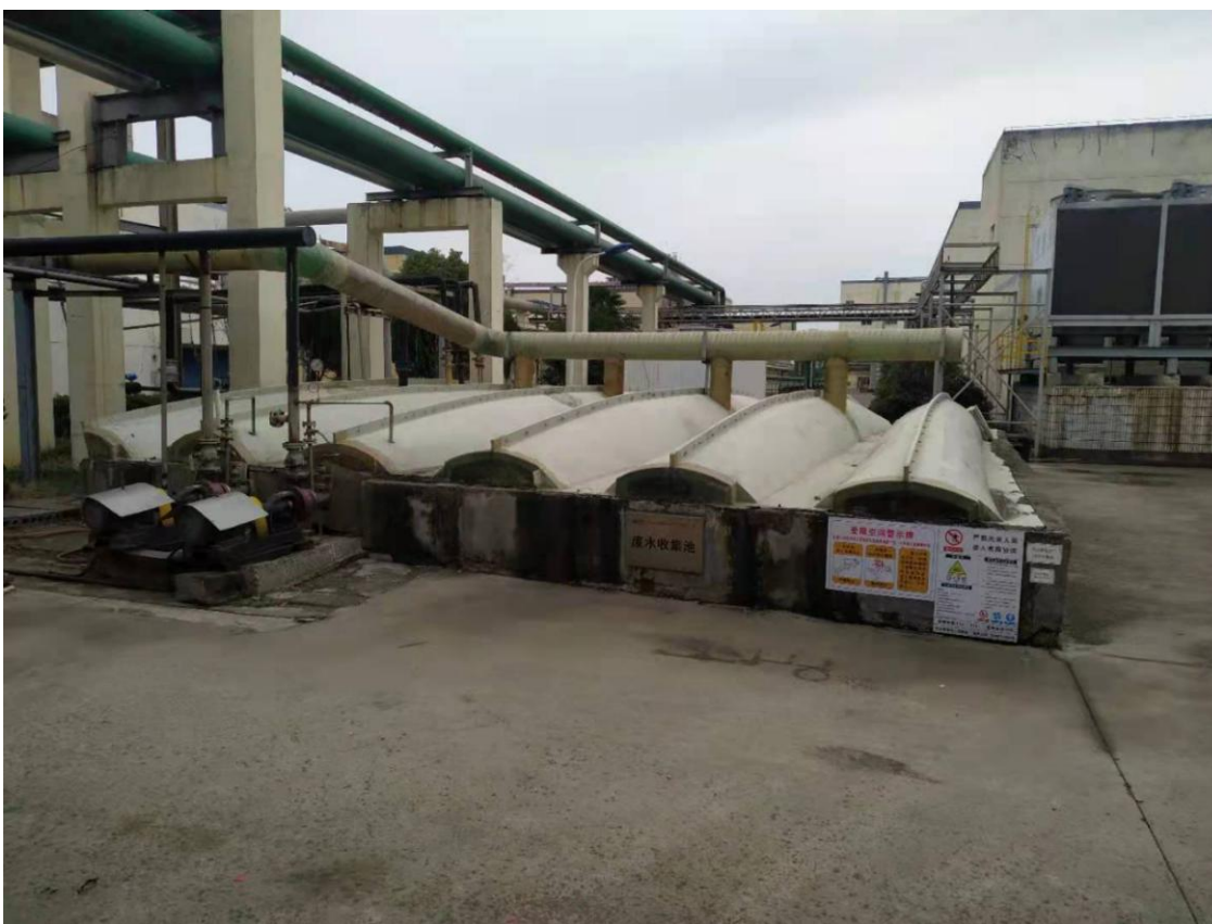
氨基酸废水预处理设施
