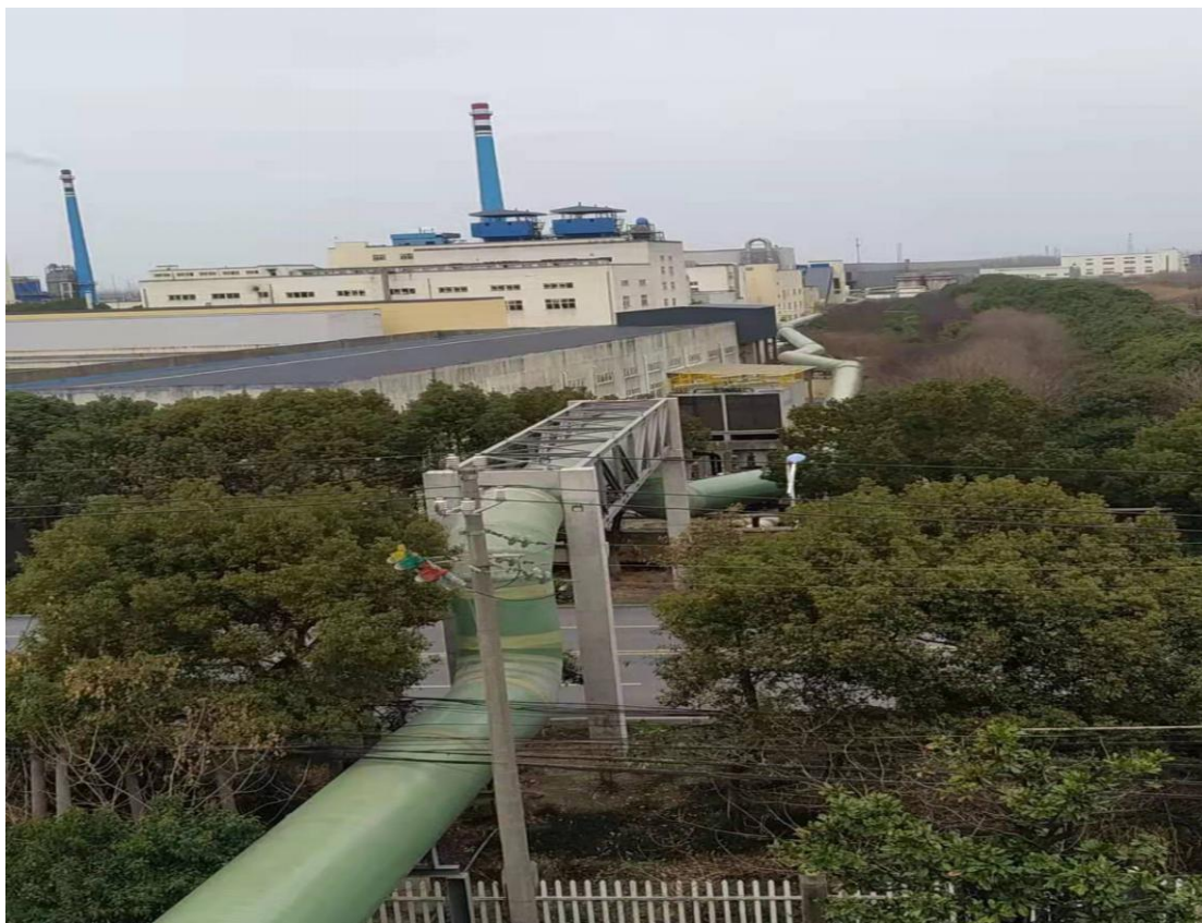
颗粒剂干燥尾气热电焚烧系统
