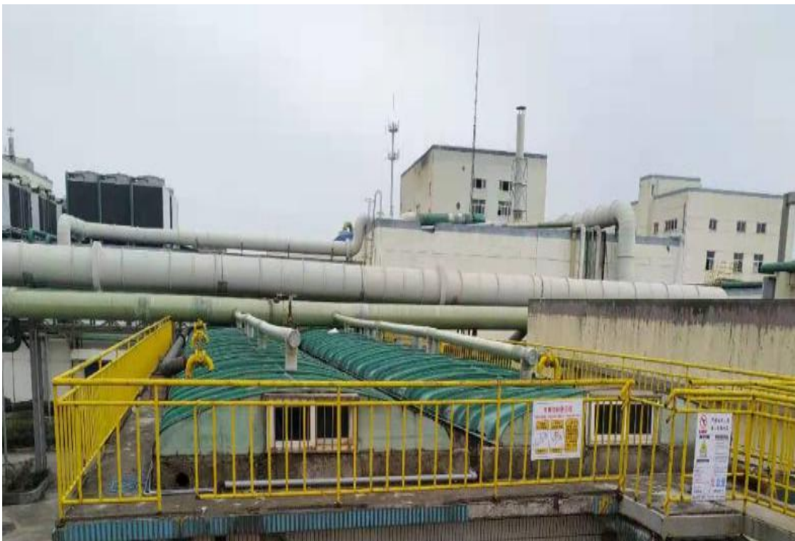
氨基酸废水预处理设施
